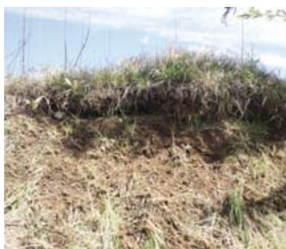
Freigelegte Böschung mit vor Erosion schützender überkragender Hangkante
